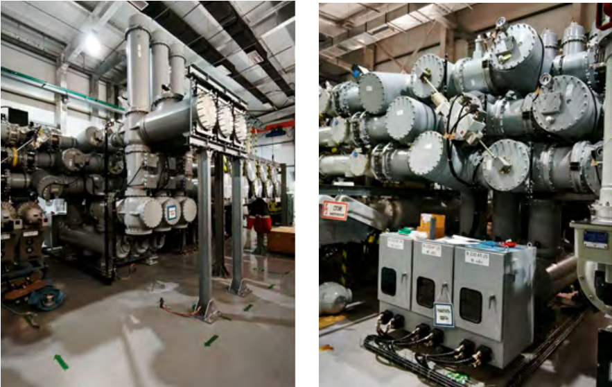
Рис. 3. Общий вид КРУЭ с новой ячейкой 220 кВ «Электроаппарат»
