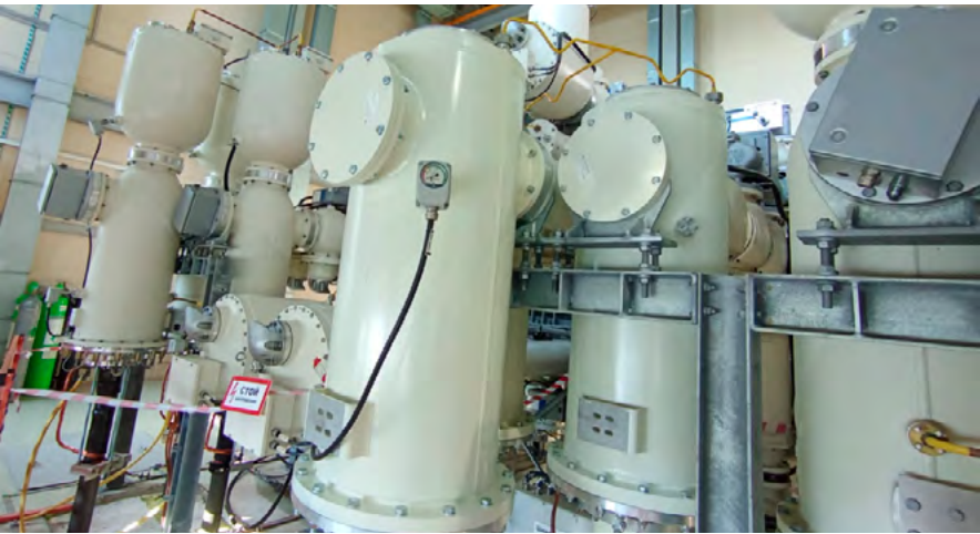
Рис. 7. Общий вид установленного кабельного отсека «Электроаппарат» в КРУЭ Siemens.
