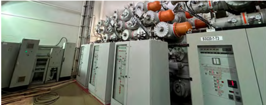
Рис. 5. Вновь установленные ячейки КРУЭ 220 кВ
