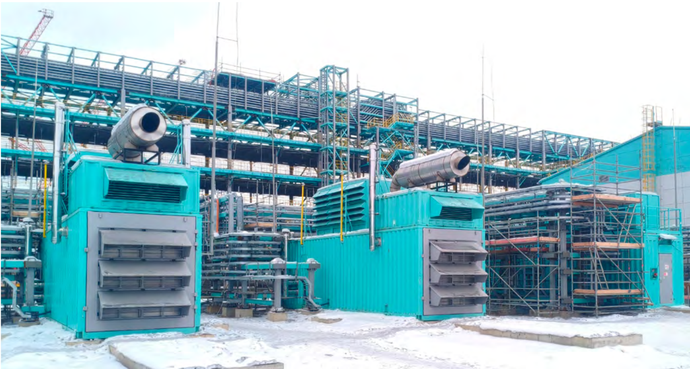
Один из последних проектов ПСМ: энергоцентры для СПГ-завода в п. Усть-Луге. Общая мощность проекта превысила 34 МВт
