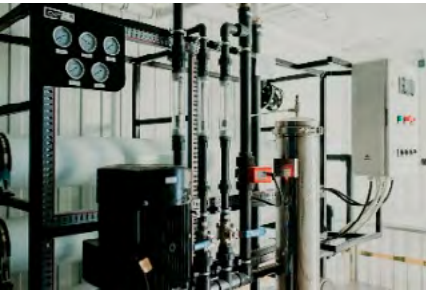
Станция очистки отработавшего геотермального флюида
